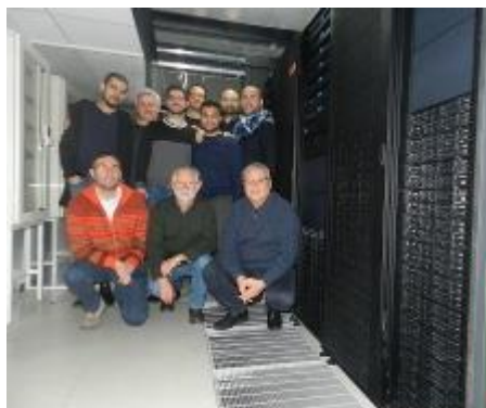
CRESCO6 in fase di installazione
